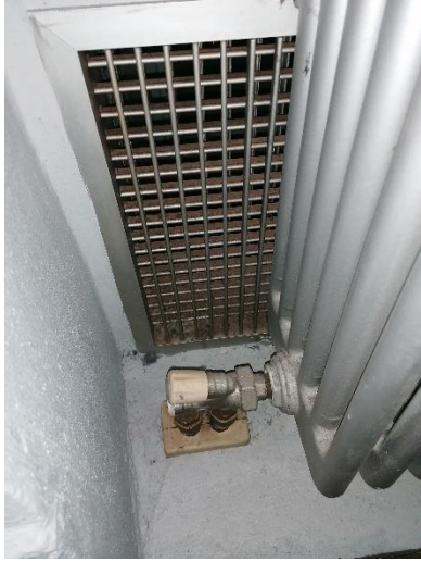
Foto 6 – Bocchetta posizionata dietro il calorifero nella platea centrale
