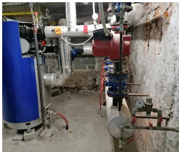
Foto 10 – Centrale di teleriscaldamento
