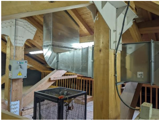
Foto 8 – Canale di estrazione dell'aria
