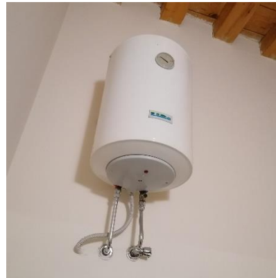
Foto 9 – Boiler da 1200W
