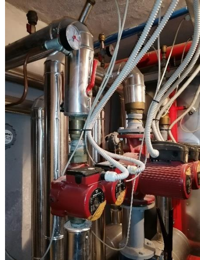
Foto 7 – Sottostazione di pompaggio nella centrale termica del teatro
